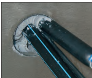
Kein Wassereintritt mehr
